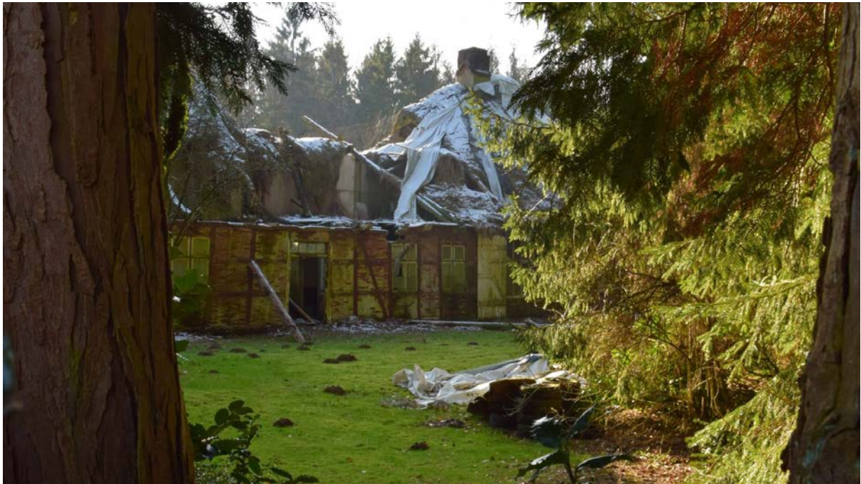
Ruinen des ehemaligen Restaurants Lohmühle. Foto: Yle / Peter Lüttge
